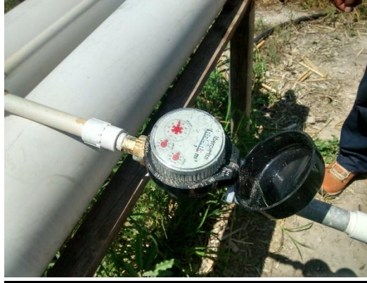
Figura 21. Medidor de flujo.
