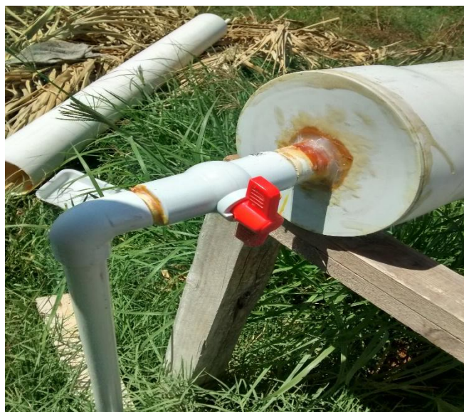
Figura 18. Parte delantera del filtro y válvula reguladora de flujo.
