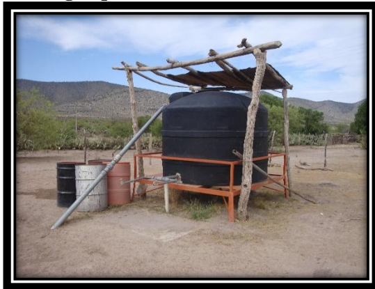
Fotografía 3. Tanque de almacenamiento de agua para el servicio doméstico
