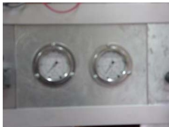
Figura 6.5 Unidad de manómetros.
