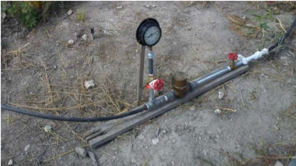
Figura 3.1. Hidrómetro y manómetro a la entrada a la línea regante.
