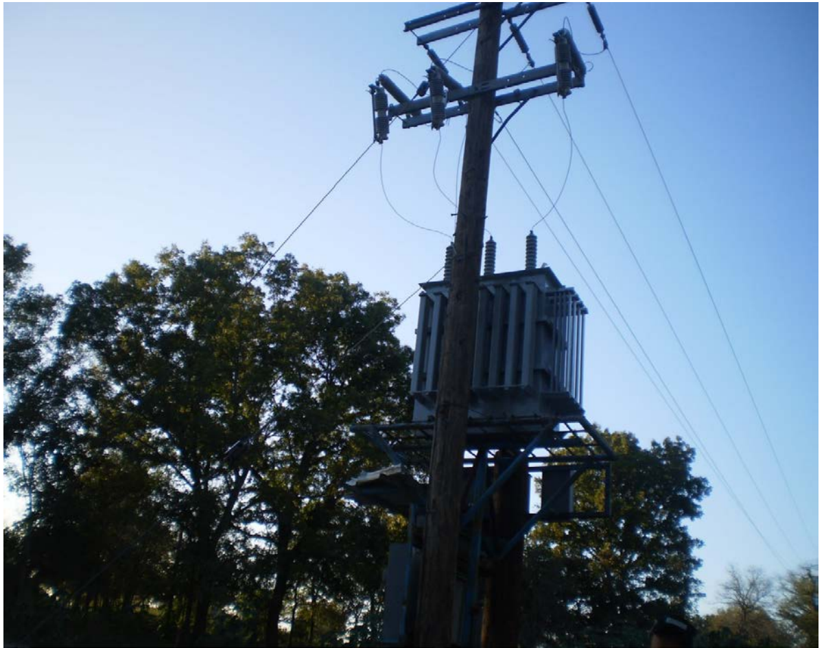
Figura 3. Subestación eléctrica, en Rancho Las Trampas, propiedad de Isaac Adrian Villarreal Budnik
