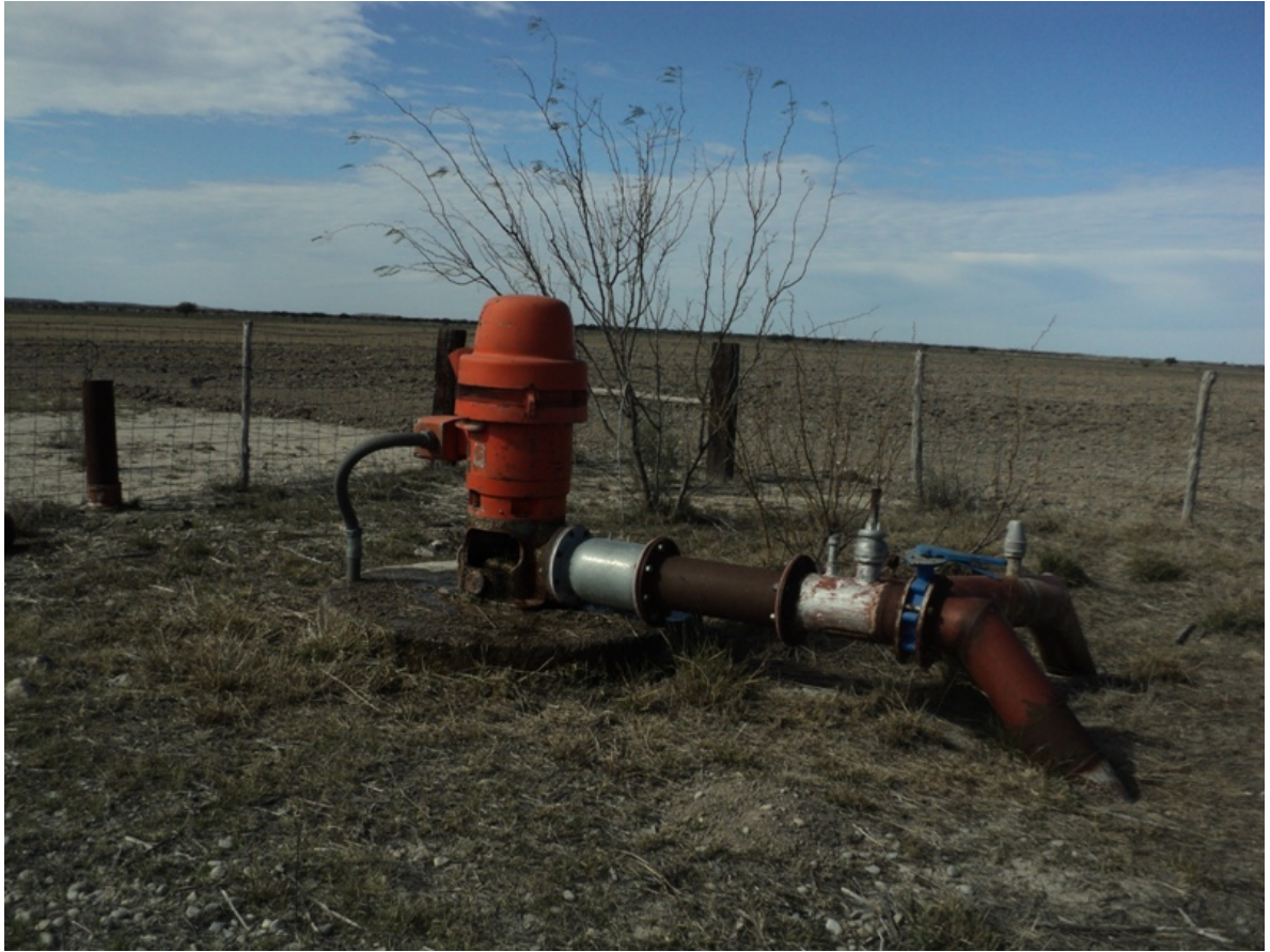
Figura 2. Sistema de bombeo vertical flecha hueca de 75 HP, motor a 1770RPM, 3F a 440V. Bomba tipo turbina marca ROBBCO PUMPS modelo 11CHO de 4 pasos con 10 años de operación; columna de 8", descarga de 8" con válvula check de 8", medidor de flujo de 8" y válvula mariposa de 8".
