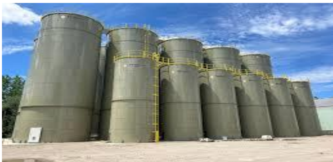
Figura 16. Tanques de silo
