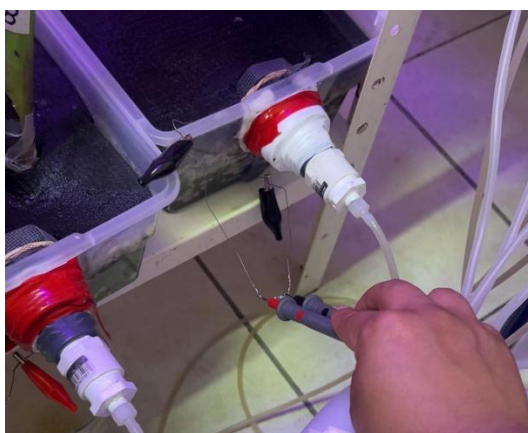
Ilustración 15. Medición de voltaje.
