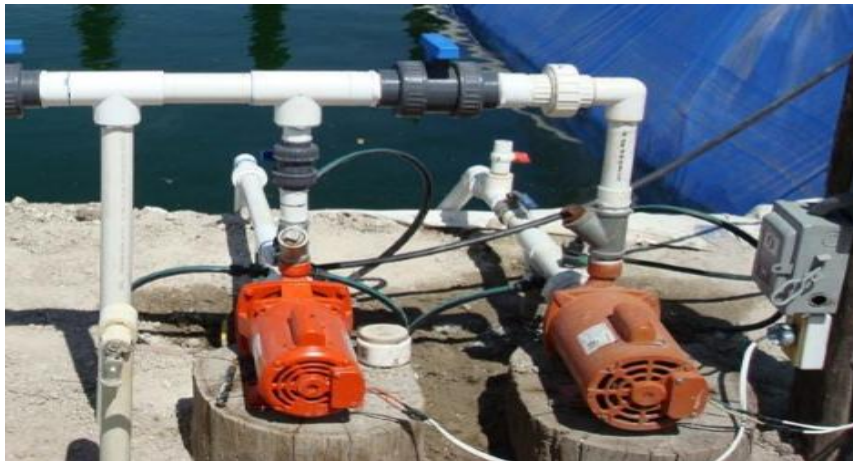
Figura 2. Conjunto de bombas centrifugas (Gómez, 2017).
