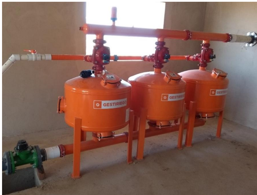
Figura 20 Conjunto de filtros de grava (Gómez, 2017).
