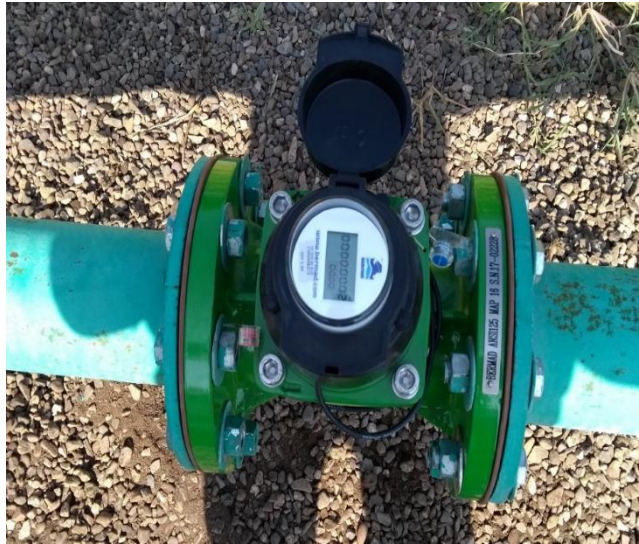
Figura 6. Medidor de flujo (Gómez, 2017).
