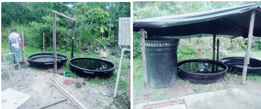
Figura 12. Instalación completa del sistema.
