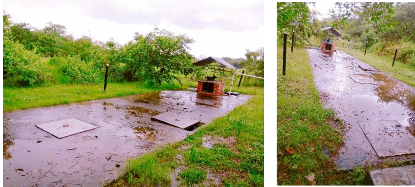
Figura 1. Planta tratadora de aguas residuales (PTAR) de la Sede.
