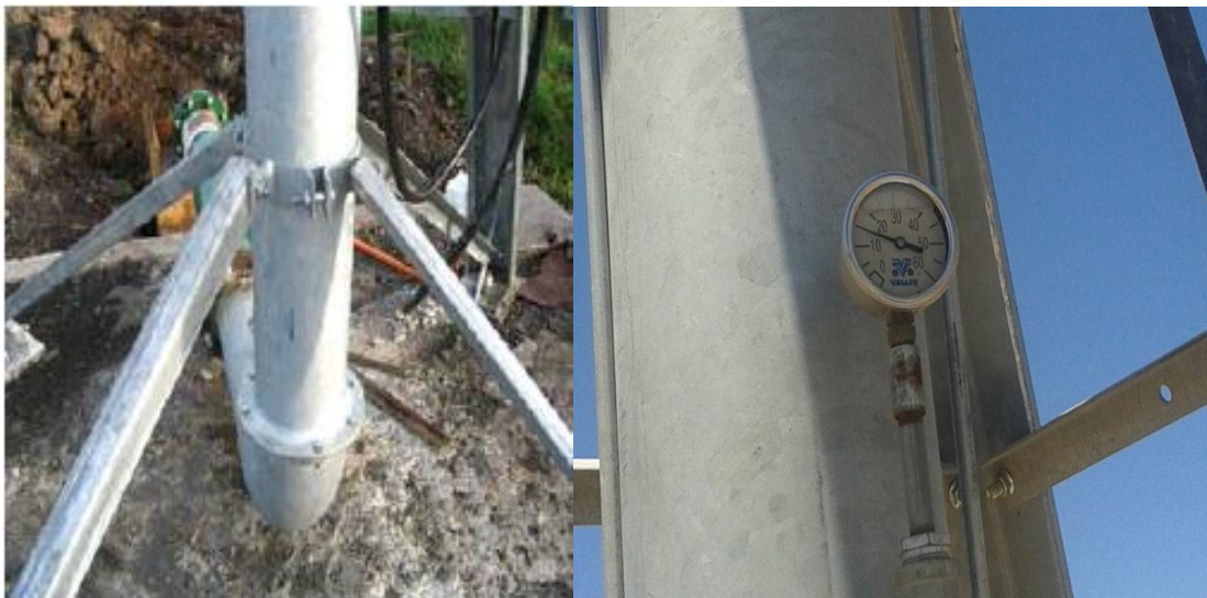
Figura 2.4 Vista entrada del agua al pivote y manómetro
