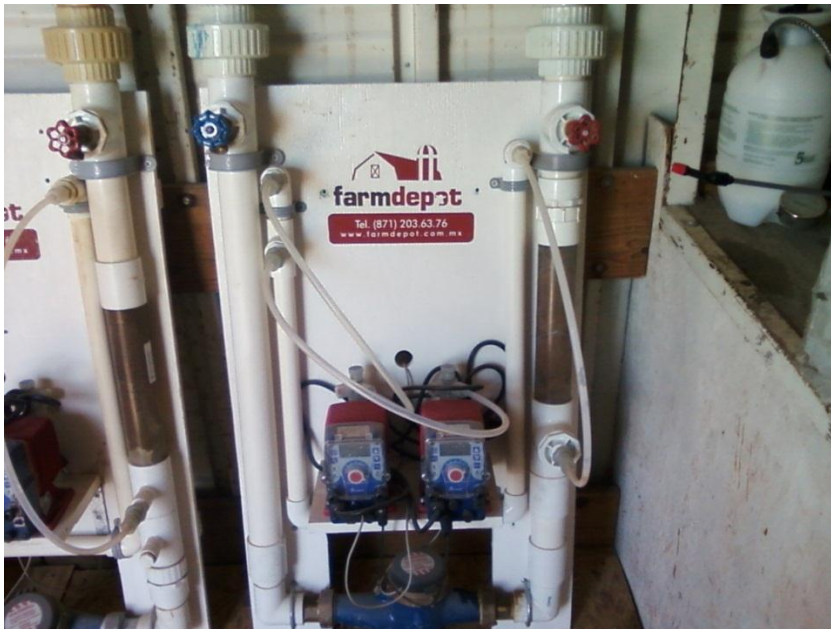
Figura 9. Dosificador de Dióxido de cloro.
