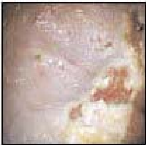
Fig3.- 2 Erosión pequeña leve
