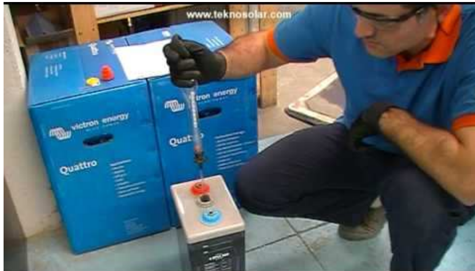
Figura 14. Medición del nivel de electrolito de la batería.
