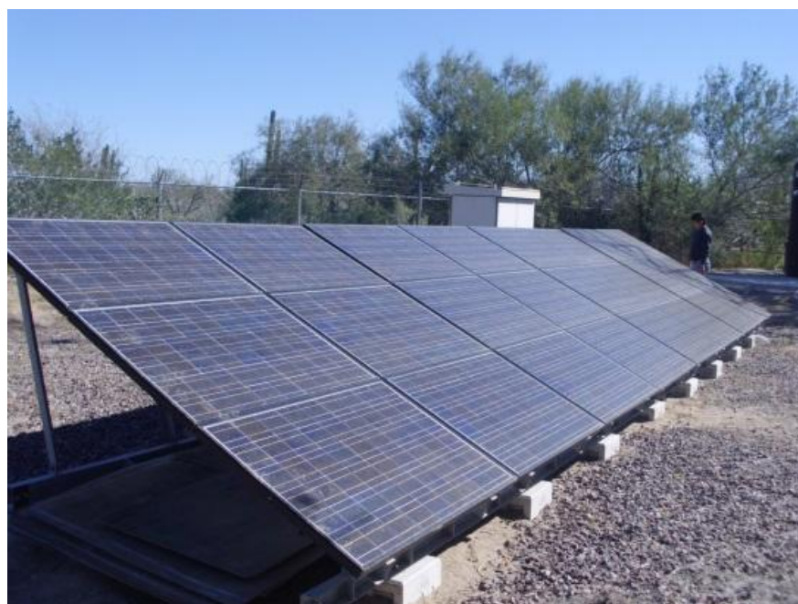
Ilustración 20. Panel solar colocado en el área del pozo agrícola del CIBNOR, para el funcionamiento de la bomba sumergible.
