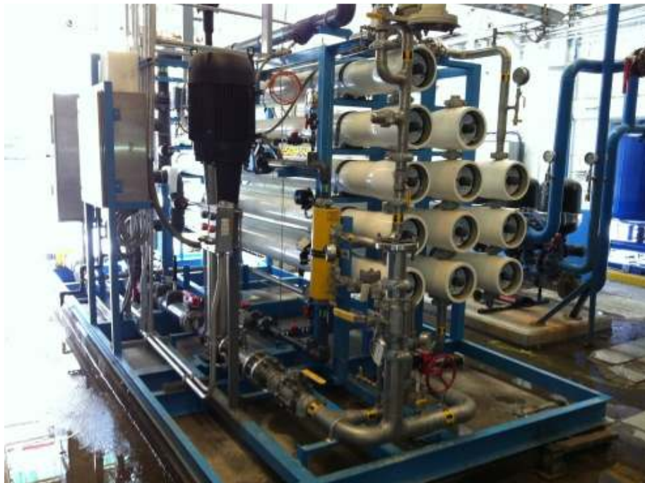
Figura 4.4. Vista A de planta de OI instalada en Peñoles.
