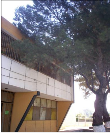
Figura 18. Daños a techos.
