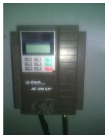
Figura 14 Variador de frecuencia
