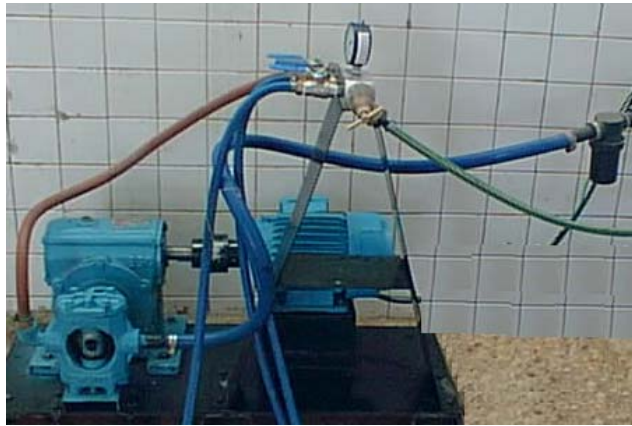
Figura 3.1.2 elementos del sistema de aspersión.
