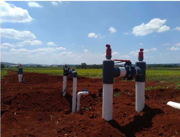
Figura 20.- Cruceros de control de líneas principales y secundarias, visto de fondo de izquierda a derecha, válvula de control línea principal 8" válvula cepex mariposa, válvula de control de línea secundaria 3" válvula hidráulica reguladora de presión, y al final crucero de control de línea principal de 6" válvula cepex mariposa.
