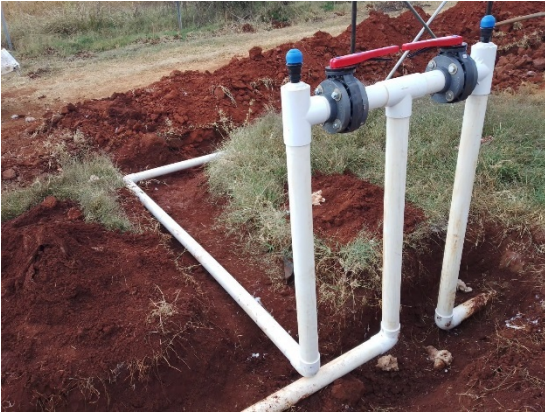
Figura 50.- válvulas de control rumbo a olla y a sistema de riego, con válvulas mariposa cepex de 3", bridas cedula 80 de 3", tee y codos cedula 40 de 3", tubería rd-41 de 3", reducciones bushing cedula 40 y válvulas de aire de 1".
