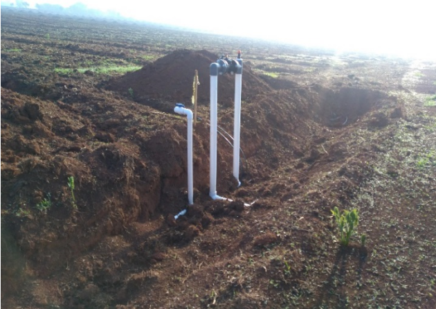
Figura 15.- Crucero de línea secundaria instalada con válvula hidráulica reguladora de presión Berman 3", piezas en cedula 80, válvula de aire, manómetro, y purga de línea secundaria a lado, con válvula esfera económica 2" y coco cedula 40.
