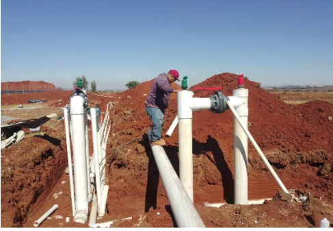
Figura 59.- Colocación de cruceros de control de línea principal de 8" con válvulas cepex y piezas en cedula 40, y colocación de válvulas hidráulicas de 3" y 2" para la alimentación y control de las líneas secundarias de 2 sectores.
