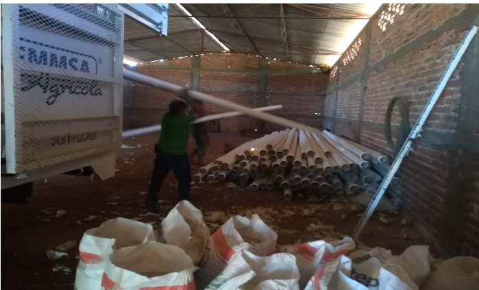
Figura 13.- Entrega de tubería pvc de 4",3" y 2", de uno de nuestros proveedores en una bodega del terreno.
