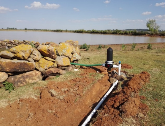
Figura 48.- Filtro fijo 3" Adritec, manguera verde olivo succión 2", adaptadores hembra 2", tee cedula 40 2", válvula de aire 1", reducción bushing 2" x 1" roscada, y manómetro wade rain de 0 – 60 lb.
