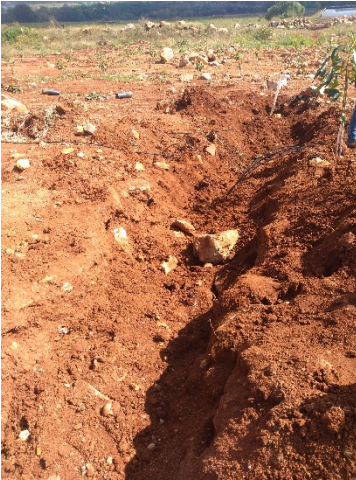
Figura 26.- Línea secundaria tapada sin precaución y con piedras, lo cual generó problemas de rompimiento de tuberías al compactar y tapar la zanja.
