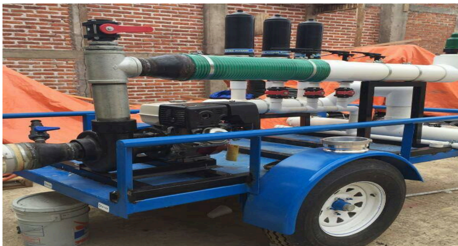
Figura 2.- Bombeo y Filtración móvil de 4" en remolque, 3 filtros anillos, válvulas mariposa 3" wade rain, válvulas biline 2", conexiones pvc, y válvula de aire y piezas galvanizadas.
