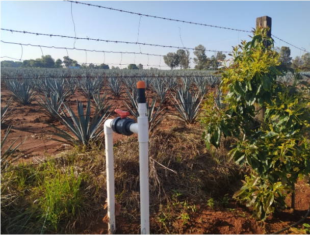
Figura 36.- Crucero de control de línea secundaria, con válvula cepex doble tuerca 1 ½", tee y codo 1 ½" cedula 40, tubería rd-26 1 ½", reducción bushing de 1 ½" x 1", y válvula de aire de 1" wade rain.
