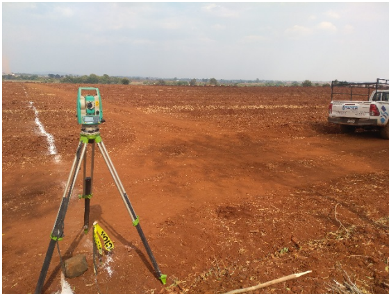
Figura 11.- Medición de terreno mediante Estación Total Gowin y encalado de línea secundaria.
