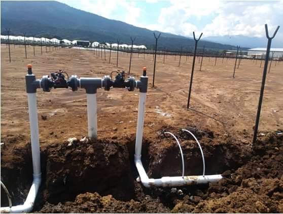
Figura 5.- Cruce de doble líneas secundarias, válvulas hidráulicas reguladoras de presión 3", piezas cedula 80, válvulas de aire WR 1" y tubería pvc.
