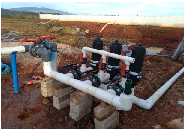
Figura 29.- Instalación de Filtración Fija para tubería de pozo de 4", 3 filtros anillos 3", 3 válvulas mariposa wade rain 3", 6 bridas 3" cedula 80, 3 válvulas biline 2", válvulas mariposa cepex 4", codos, te y bridas 4" cedula 80, y válvula de aire de 1" irritec.
