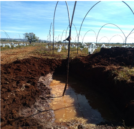
Figura 31.- Fuga en línea secundaria 4" dañada por estaca de macro túnel.
