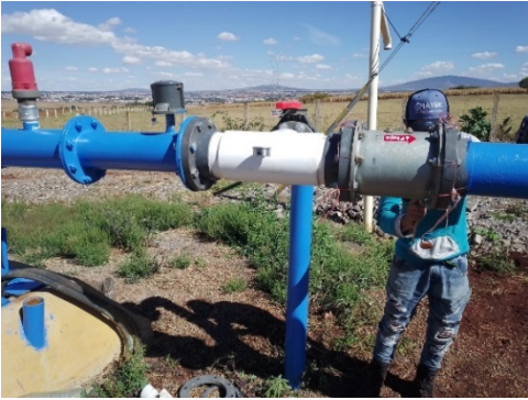
Figura 46.- Equipamiento de conducción de pozo en rancho a hoya, con válvula check metálica doble ala de 6", bridas cedula 80 6", tee hidráulica cedula 40 de 6", desfogue de 4" con válvula mariposa cepex 4", reducción bushing de 6"x 4", medidor de flujo de aluminio y válvula de aire efectos sencillo toro 2".
