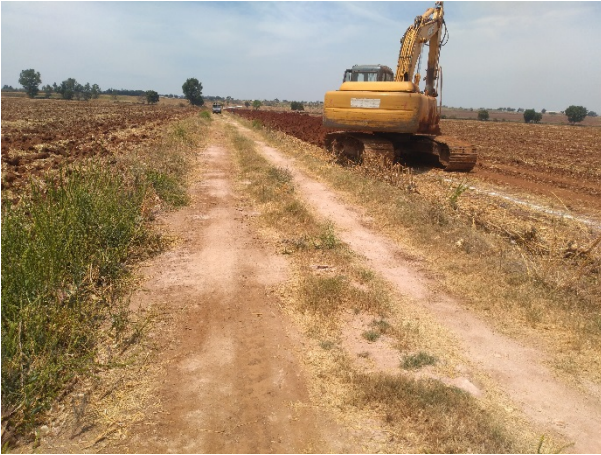
Figura 12.- Excavadora trabajando en zanja para la colocación de la línea principal de 250mm c-5.
