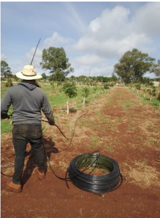
Figura 49.- Tirada de manguera 16 mm para la posterior colocación de goteros Ardas de 0-70 lph.
