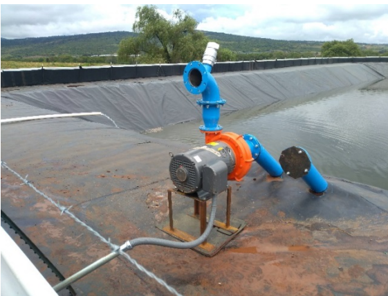
Figura 25.- Moto bomba eléctrica 30 hp, instalada por la compañía Bombas y Equipos de Riego Valadez, a partir de esta conexión nosotros llevábamos la tubería del bombeo hasta la entrada de la caseta de filtración.
