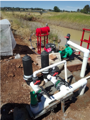
Figura 37.- Bombeo 15hp motor honda y acople a caracol y filtración fija con filtros de 3" Adritec, válvulas mariposa metálicas wade rain 3", válvulas estándar cepex 1 ½" , tubería rd-41 4",3" y 1 ½".
