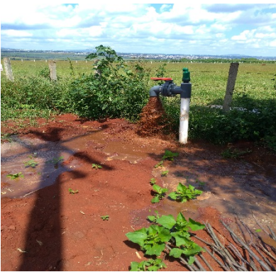
Figura 16.- Purga 4" línea principal, codo, tee y bridas cedula 80, válvula mariposa cepex 4", válvula de aire 2" efecto sencillo irritec.
