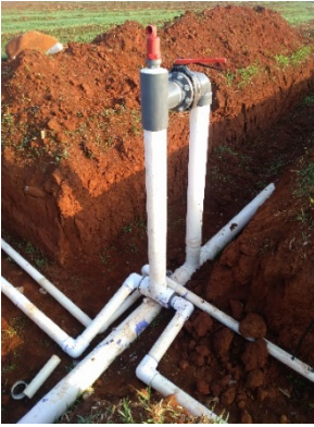
Figura 22.- Crucero de control de línea principal con válvula cepex mariposa de 6", bridas, tee, y codo de 6" en cedula 80, válvula de aire doble efecto 2" unirain, tee 6" cedula 40, reducciones bushing de 6" x 4", codos de 4" cedula 40, tubería pvc rd-41 de 6", 4" y 3", tubería métrica de 200 mm c-5 y tee de 200m x 6" c-7.
