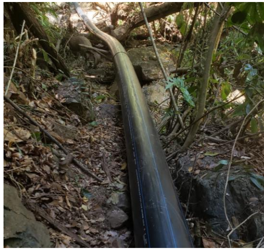
Figura 4.16 Línea principal tubería PEAD.
