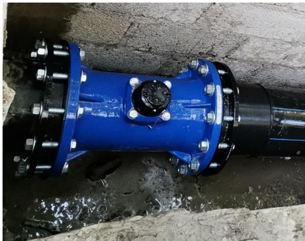
Figura 4.14 Medidor de flujo instalado en campo.
