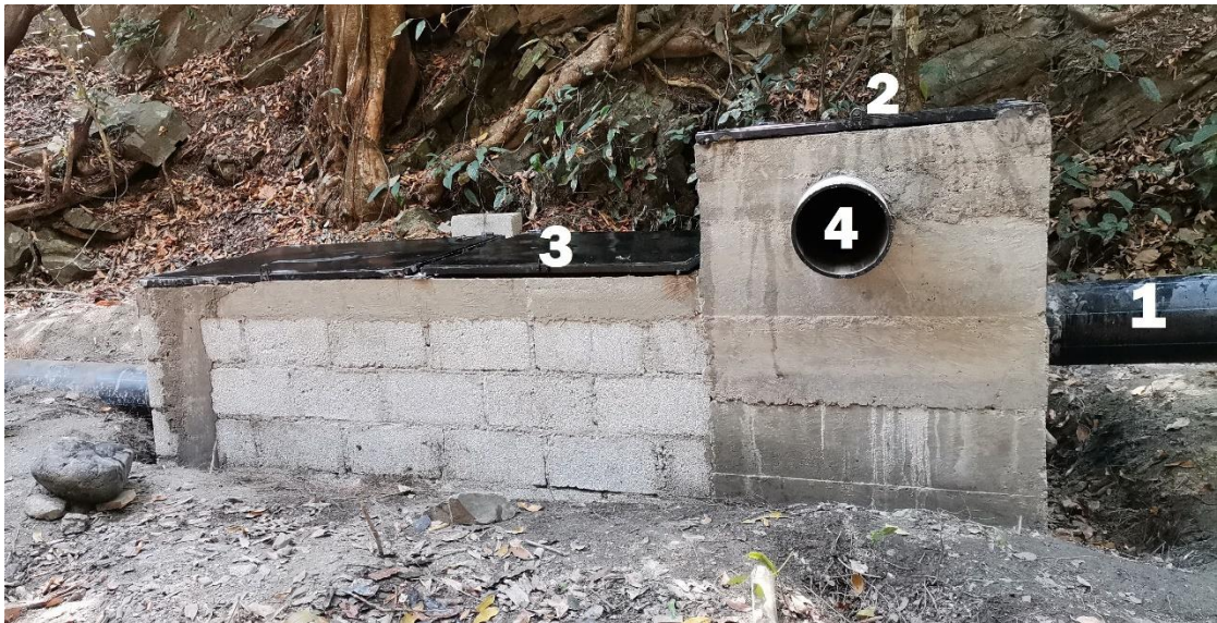
Figura 4.9 Obra de toma indirecta de manantial.
