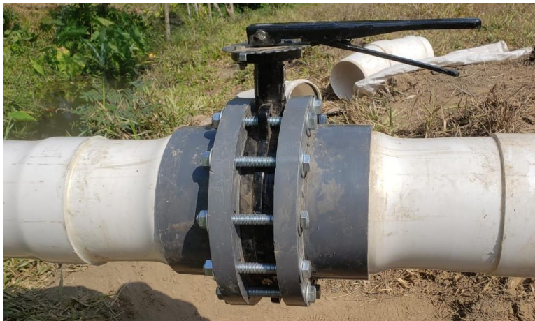
Figura 4.19 Válvula de seccionamiento.
