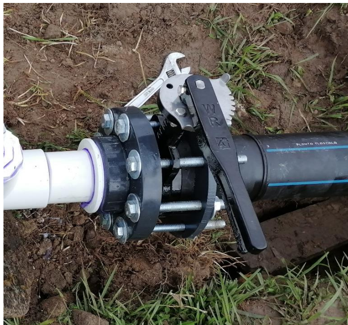
Figura 4.12 Válvula mariposa instalada en campo.
