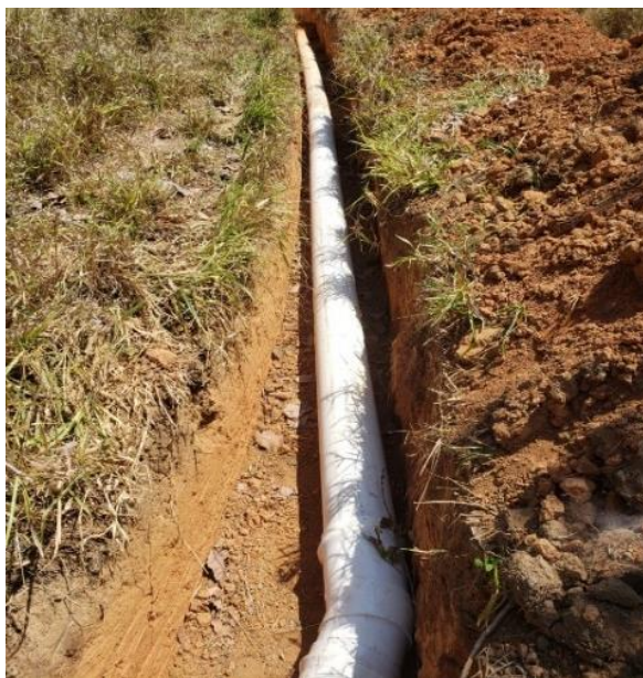
Figura 4.17 Línea de tubería principal de PVC.
