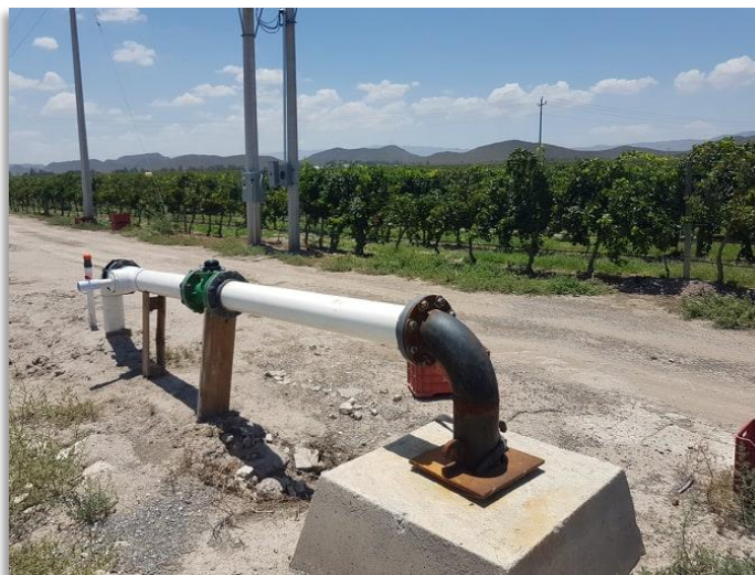
Figura 2. Sistema de riego de bombeo
