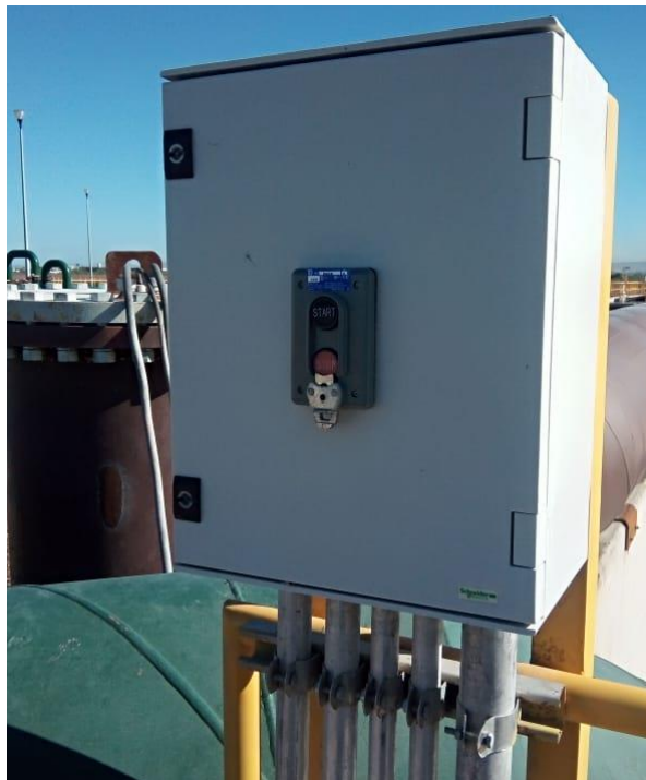
Fig. 38 Botonera local de recirculación interna
