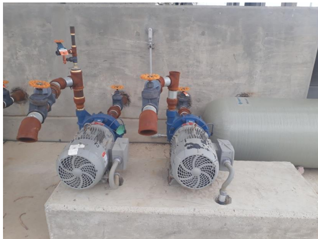
Fig. 62 bombas de lavado de espuma
