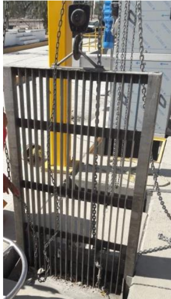
Fig. 6 Rejilla para gruesos a nivel de piso.
