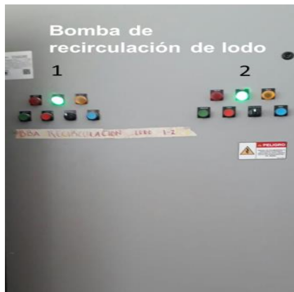
Fig. 53 Bomba de recirculación de lodo en el CCM
