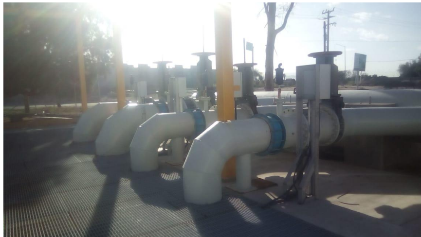
Fig. 19 Bombas del cárcamo de bombeo
