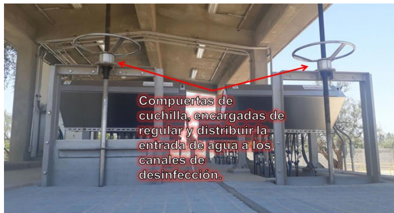
Fig. 60 Compuertas reguladoras de flujo en desinfección.
