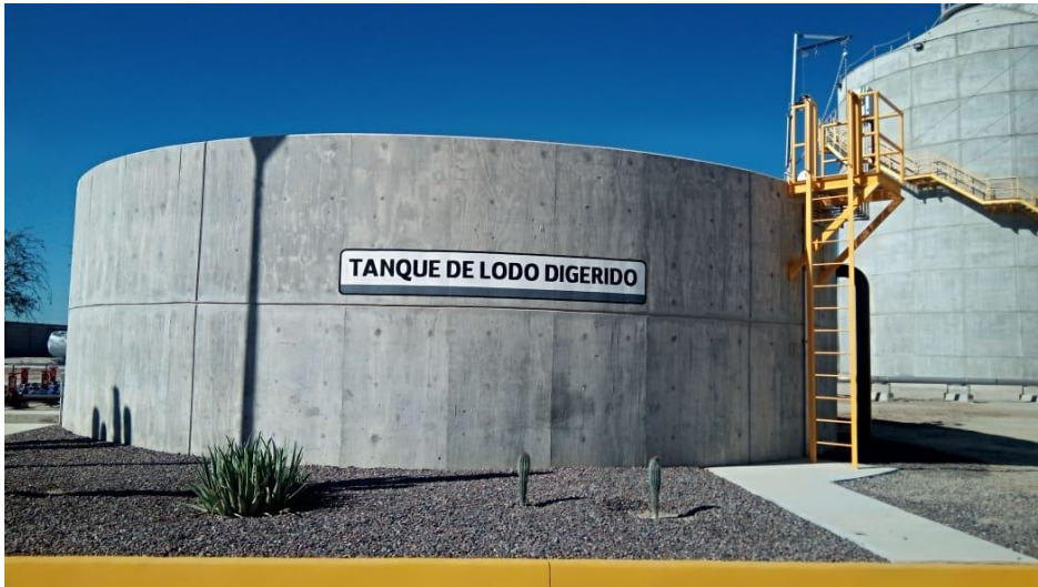
Fig. 75 Tanque de lodo digerido
