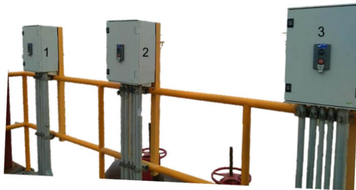
Fig. 54 54 Botonera local de bombas de recirculación de lodos
