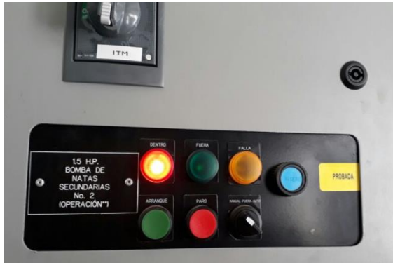
Fig. 58 Bomba energizada y funcionando.
