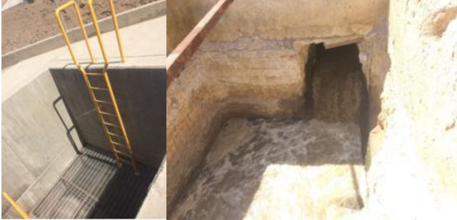
Fig. 1 Cárcamo de llegada del agua cruda (Der. Antiguo, Izq. Actual).
