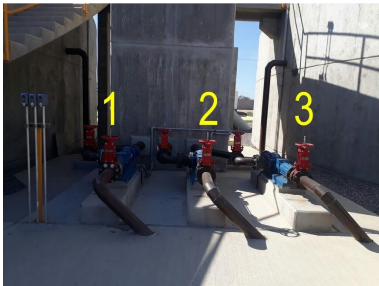
Fig. 29 Válvulas de cuchilla roja de las bombas MOYNO.
