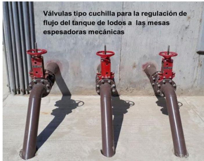
Fig. 56 válvulas tipo cuchilla para regulación de flujo de lodos.
