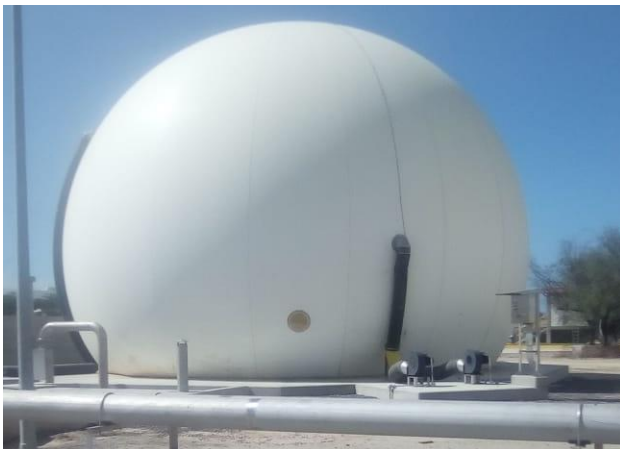
Fig. 72 Tanque de almacenamiento de gas
