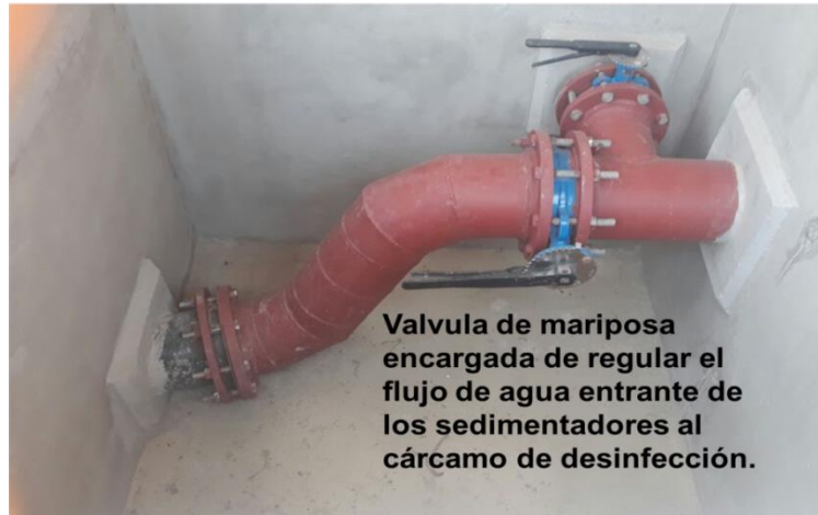
Fig. 61 válvulas mariposa de sedimentadores a desinfección.
