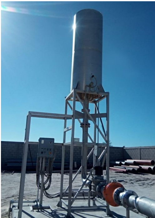
Fig. 73 Quemador de biogás
