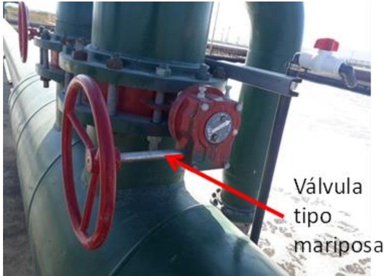
Fig. 37 Válvula de regulación del tanque aerobio.
