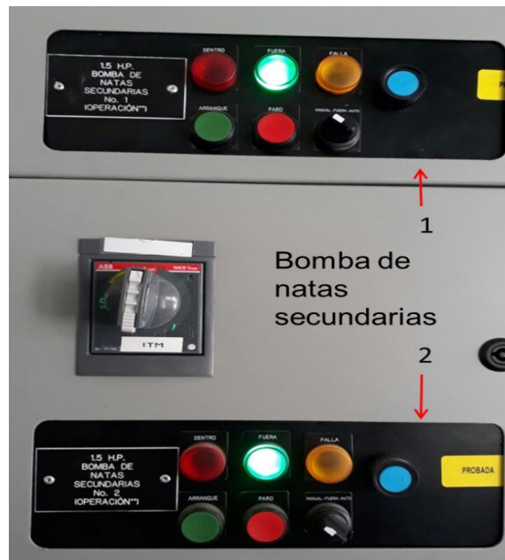
Fig. 57 Bomba de natas secundarias en el CCM
