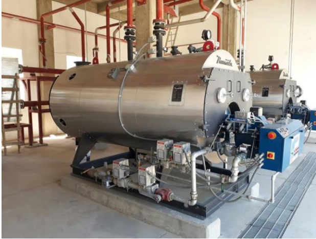
Fig. 74 Cuarto de calentamiento de lodos.
