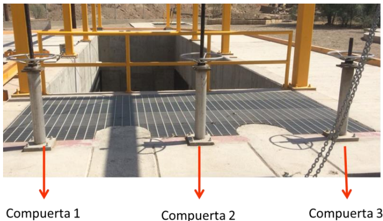
Fig. 4 Ubicación de las compuertas de entrada de agua a las rejillas
