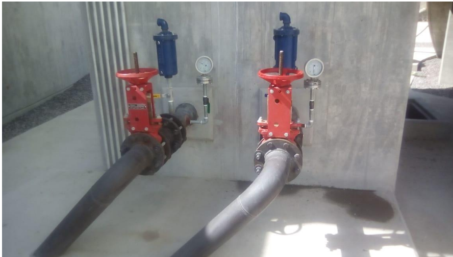
Fig. 31 Válvulas y manómetros de las bombas KSB sumergibles de 1.5 HP
