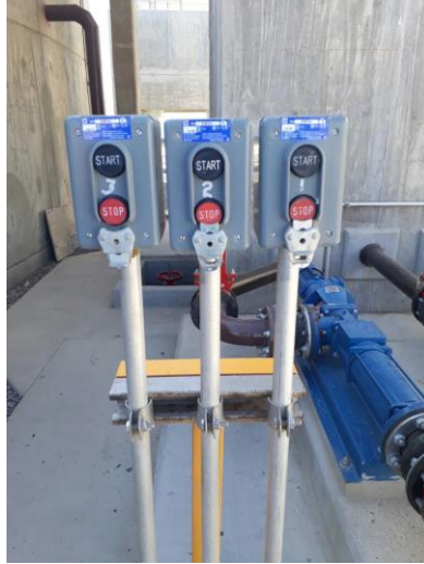
Fig. 28 Botoneras de las bombas MOYNO
