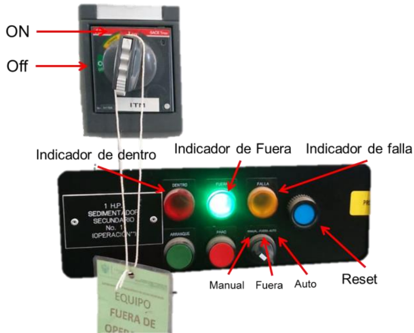
Fig. 52 Botonera de las válvulas en el CCM.
