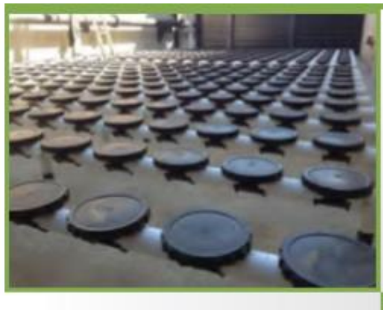
Fig. 36 Difusores instalados en la sección aerobia
