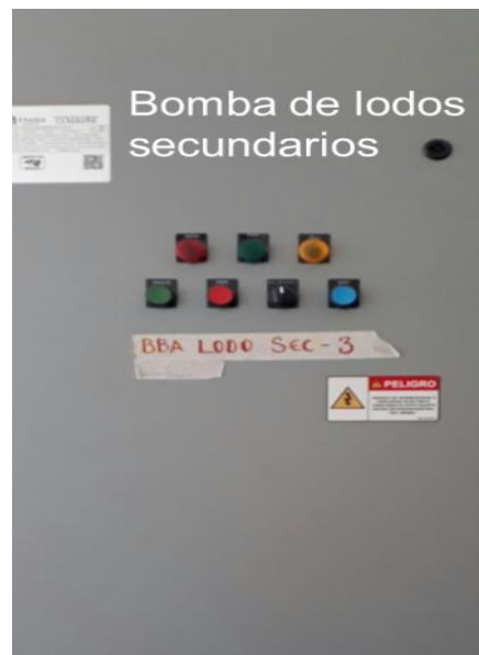
Fig. 55 Bomba de lodos secundarios en el CCM.
