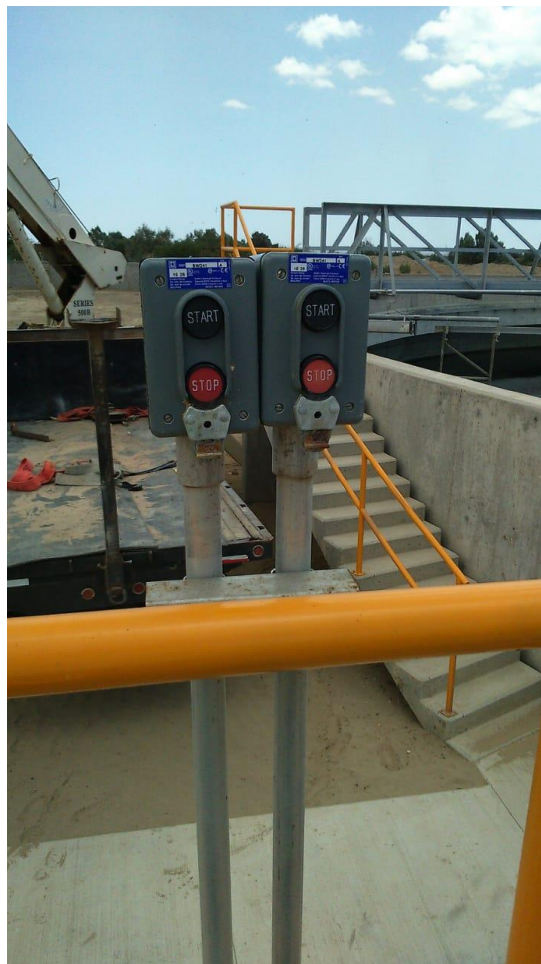
Fig. 59 Botonera local de Bombas sumergibles chicas del cárcamo de natas.
