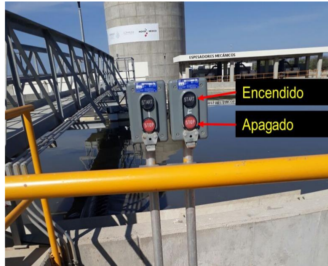
Fig. 30 Botonera local de Bombas KSB sumergibles.
