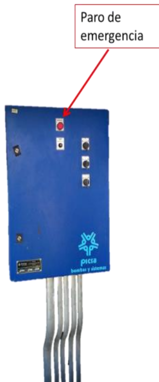
Fig. 65 Botonera local de bombas PICSA
