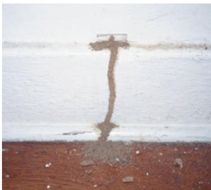
Fig.11 Formación de túneles o galerías
