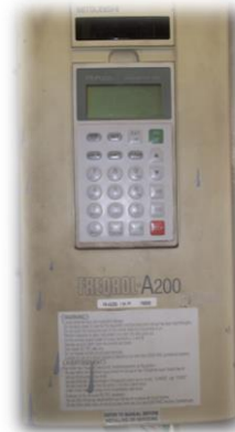
Figura 3.11. Variador de frecuencia.
