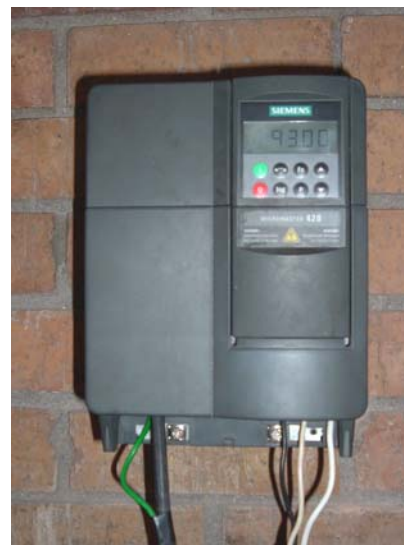
Fig. 4.17 Variador de frecuencia.
