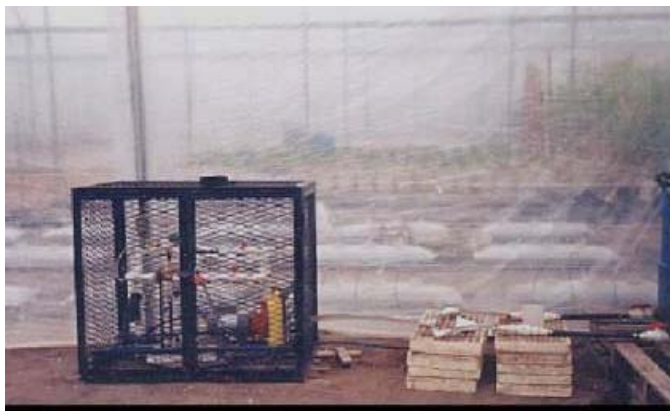
Figura 14. Equipo de bombeo para el sistema de riego en cultivo sin suelo
