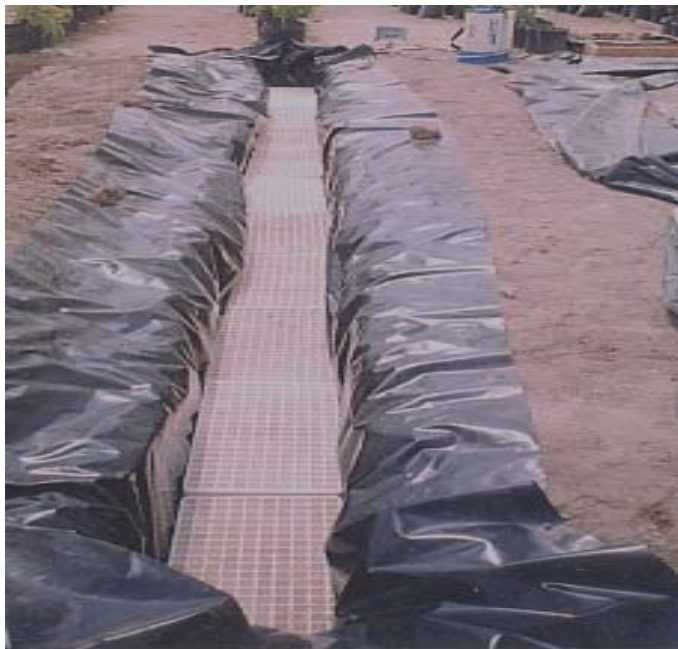
Figura 6. Zanja para el establecimiento del cultivo con suelo al momento de incluir las charolas de unicel para facilitar el drenaje.
