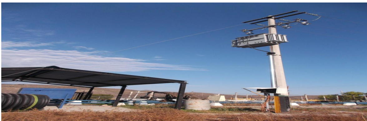
Figura 3.15. Línea eléctrica y caja de control.
