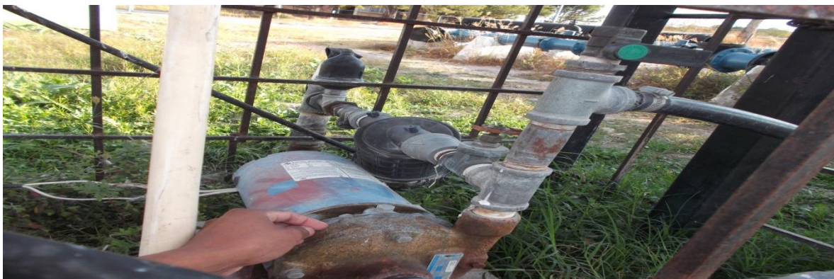
Figura 3.5. Del equipo de bombeo.
