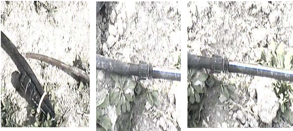
Figura 8: Instalaciones de las cintillas a las líneas regantes de cada cultivo
