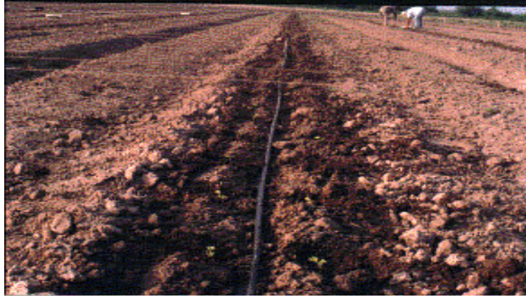
Figura No 2.- Cintilla para Riego Instalada en el Area de Cultivo.
