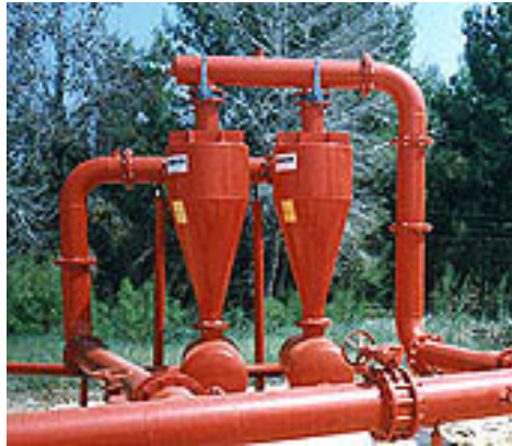
Figura 22. Hidrociclones instalados en paralelo.
