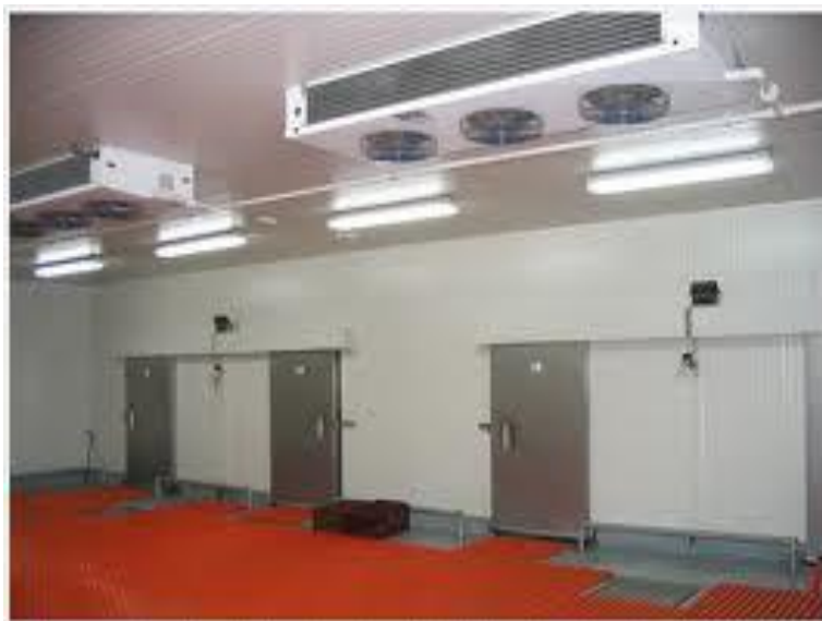
Figura 19. Cámara frigorífica (Fuente: cuartos fríos, 2012)
