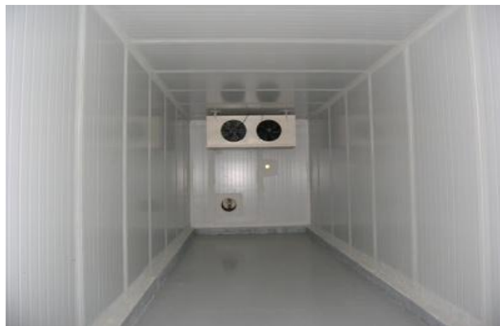
Figura 12. Cámara de Almacenamiento
