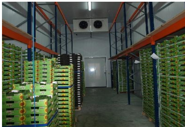
Figura 18. Almacenamiento refrigerado (Fuente: Agrouls, 2012)
