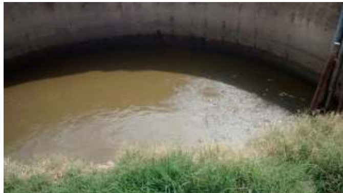
Figura 2. Cárcamo de llegada de agua residual
