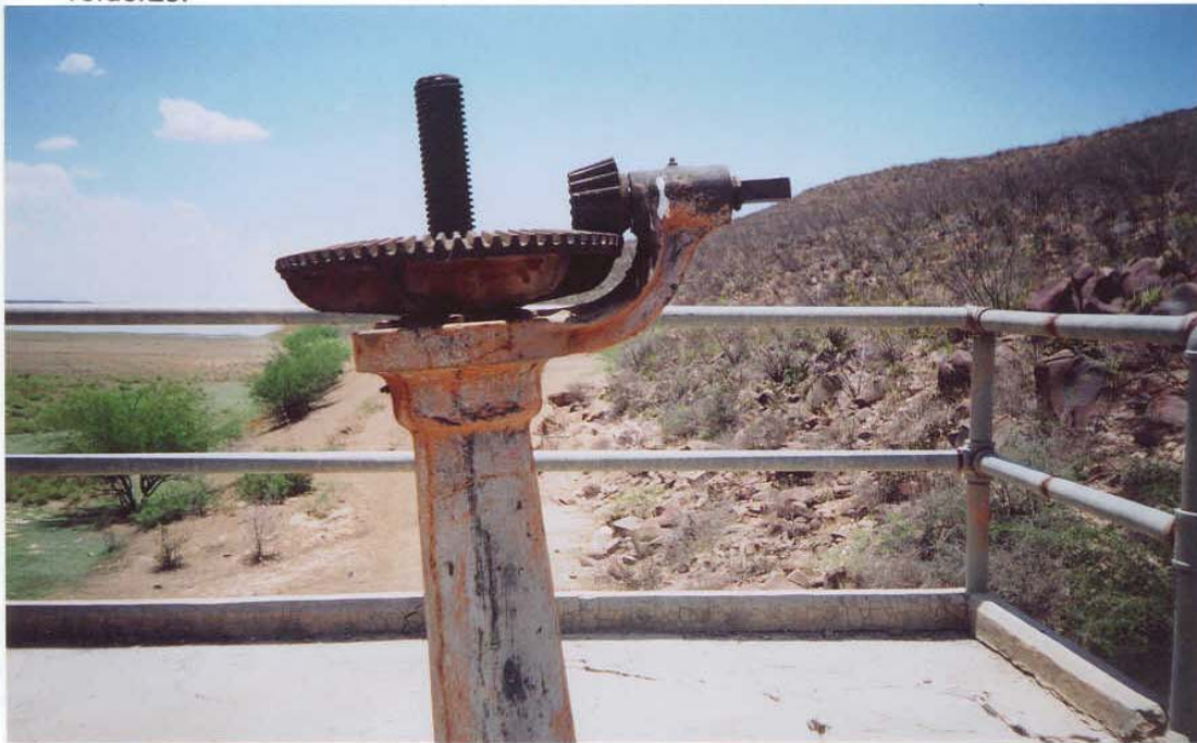
FO 5. Obra de toma. Mecanismo elevador para servicio muy descuidado e inclinado por la rotura del piso de operación.
