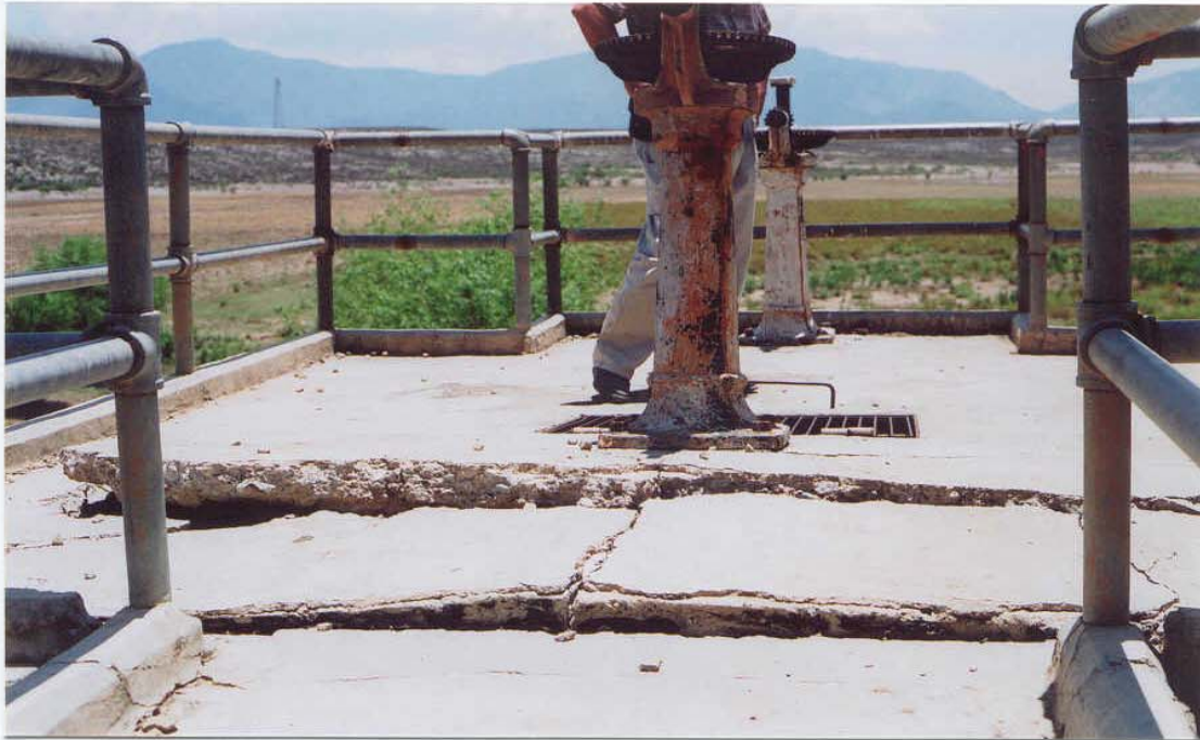
FO 4. Obra de toma. Véase la losa del piso de operación totalmente fracturada y sin acero de refuerzo.
