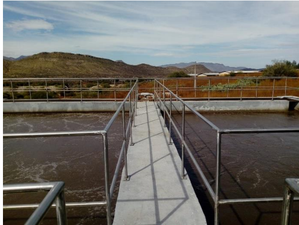
Figura 4. Reactor Biológico, lado cárcamo y lado Universidad.
