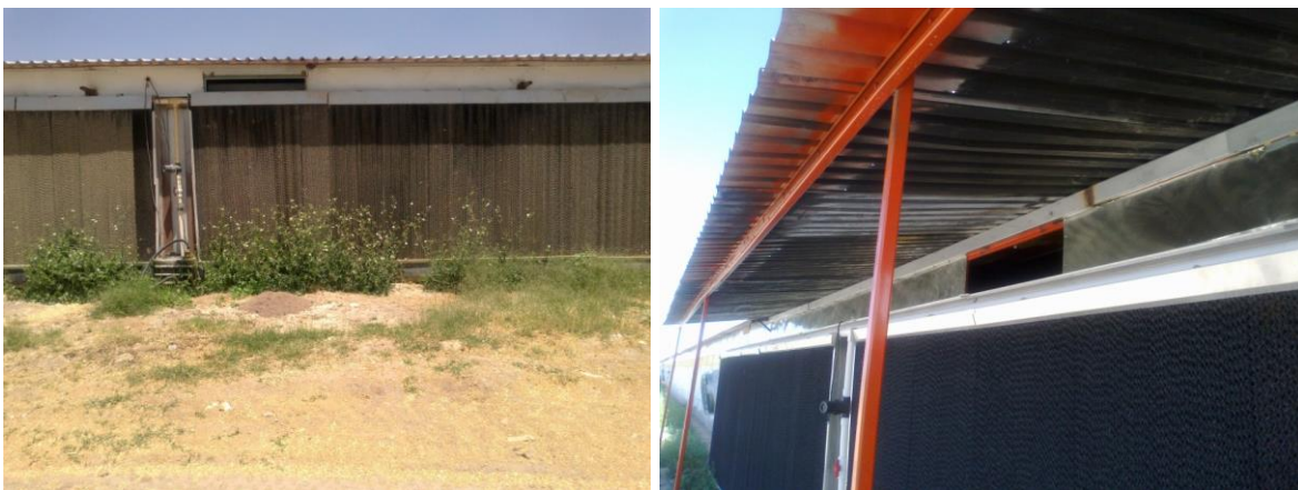
Figura 29 y 30: Maleza en pared húmeda y ventilas (inlets) abiertos en túnel (comarca lagunera)
