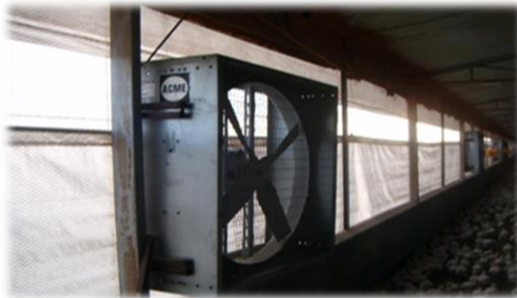
Figura 7: Ejemplo de ventilación natural (Granja Comarca lagunera)
