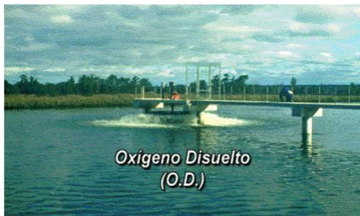
Figura 8. Laguna de estabilización con aireación mecánica.
