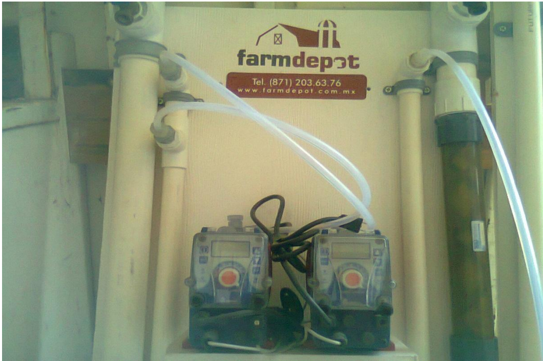
Ilustración 10. Dosificadores de dióxido de cloro e hipoclorito de sodio.
