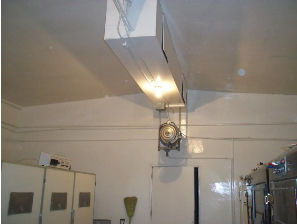
Figura 16: En el fondo se aprecia un humidificador tipo E que se utiliza para proveer humedad en salas de incubación y nacedoras.
