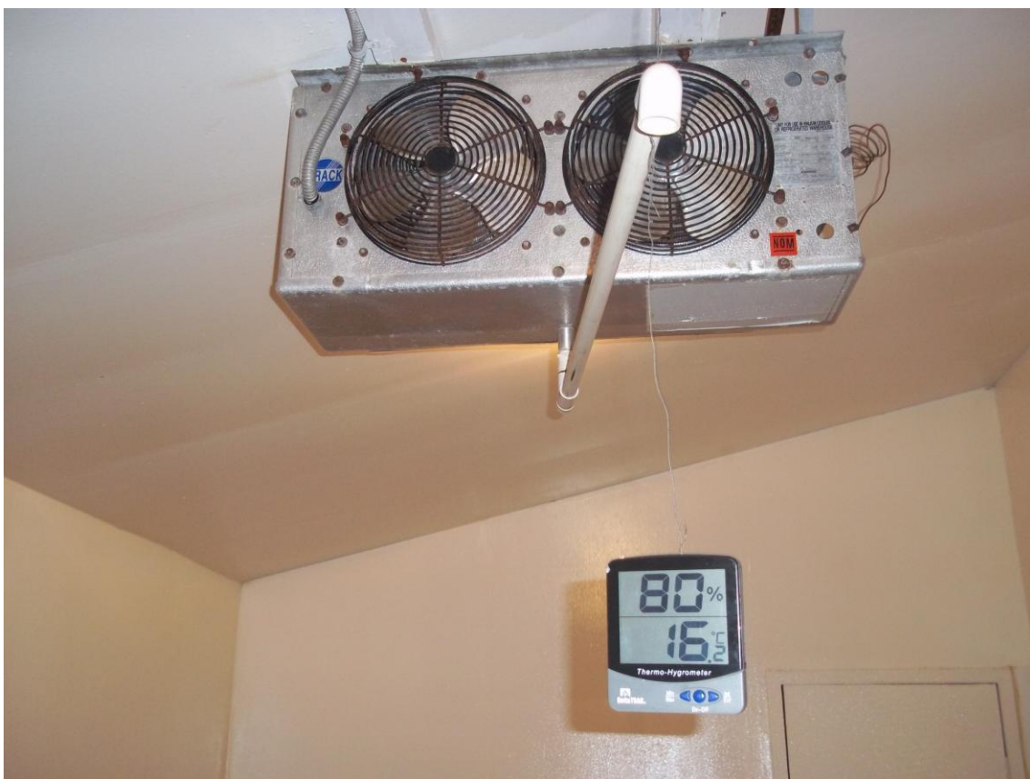
Figura 10: Aquí se aprecia un difusor de refrigeración para proporcionar la temperatura adecuada al cuarto de almacenaje de huevo incubable, a su vez podemos ver la temperatura que marca en ese momento.
