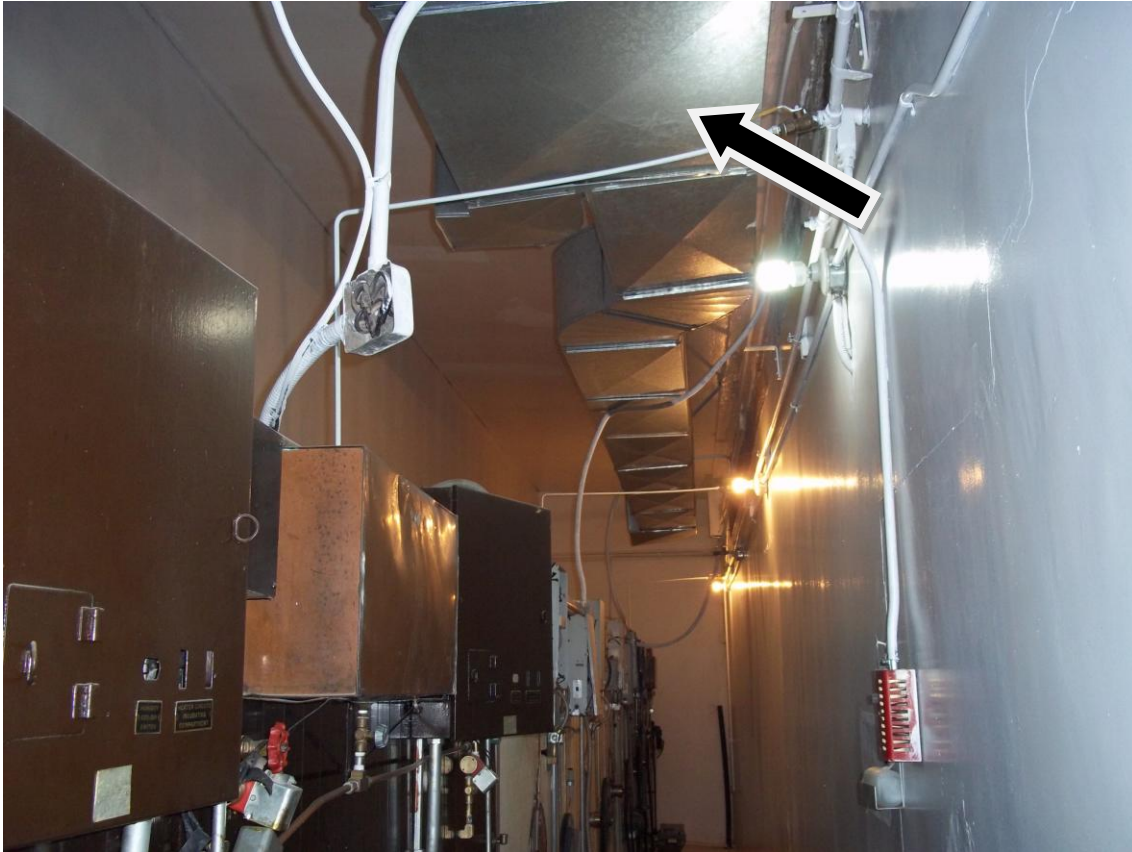
Figura 18: Ductos de Ventilación en cuarto de incubadora.
