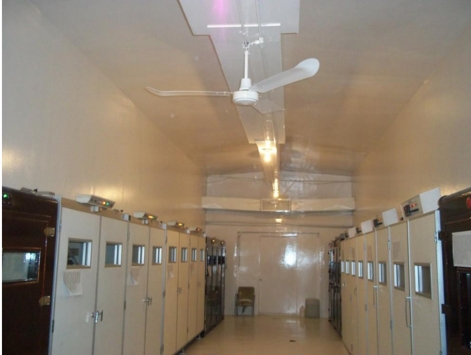
Figura 12: Sala de Incubación diseñada para realizar ahí mismo el precalentamiento con la ayuda de ventiladores de techo.
