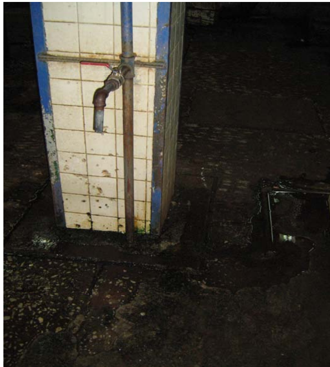
IMAGEN 6.- Estado en que se encuentra la instalación de la tubería de agua.
