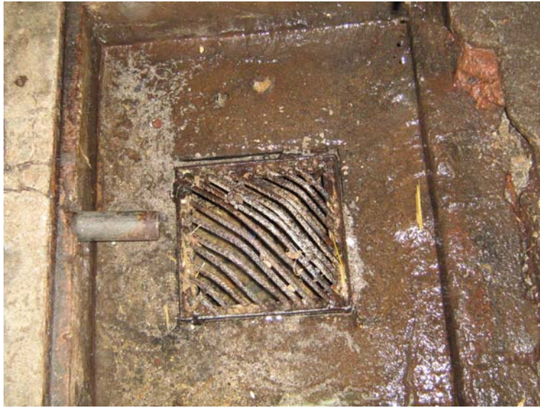
IMAGEN 7.- Sistema de drenaje y protección de las coladeras.
