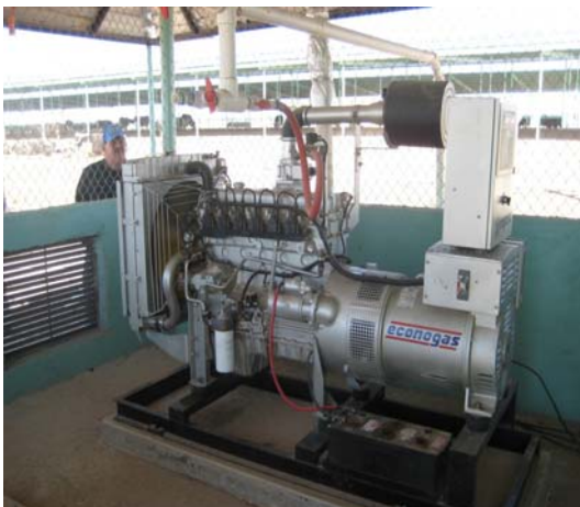
Motor generador de energía eléctrica
