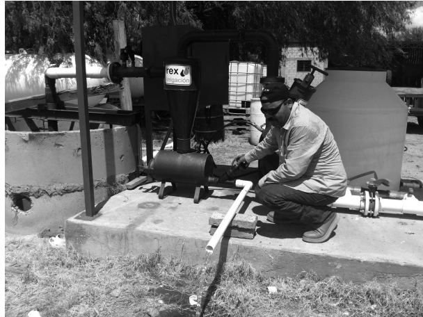
Figura 1.15. Drenado del Recipiente de Arena del Hidrociclón.
