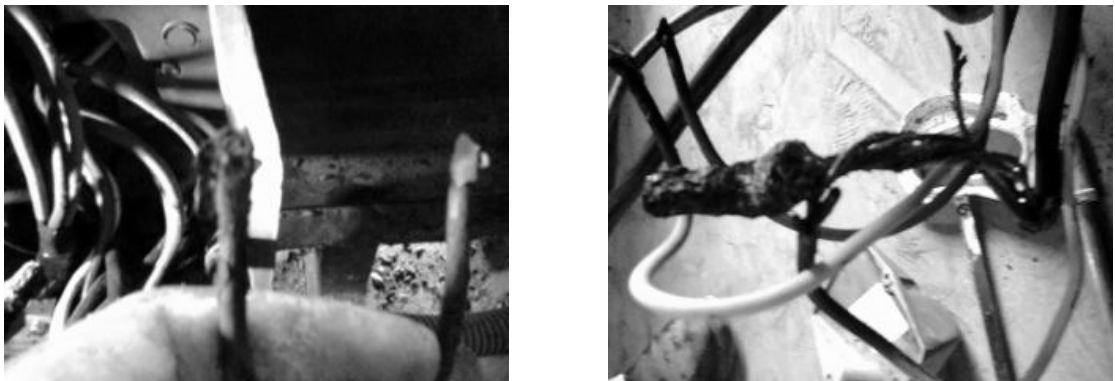
Figura 1.21. Revisión de Cableado Dañado.
