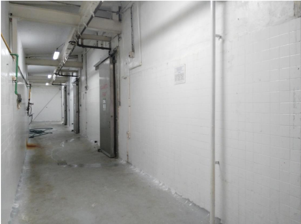
Figura 34. Pasillo de los Cuartos fríos en el área de bovinos.
