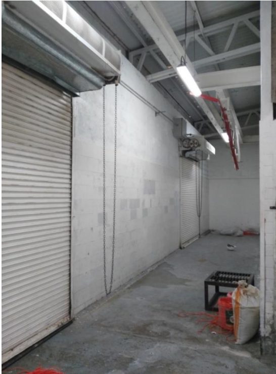
Figura 36. Puertas de Andenes en el área de bovinos.
