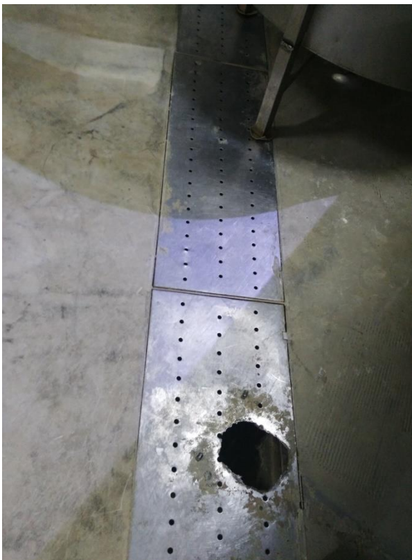
Figura 44. Orificio en el alcantarillado. Área de Viscera Verde de Bovino.
