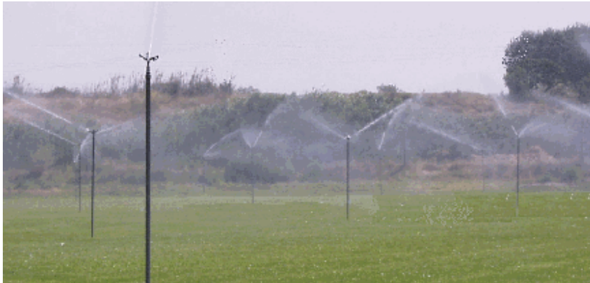
Figura 7. Sistema de riego por aspersión fijo.
