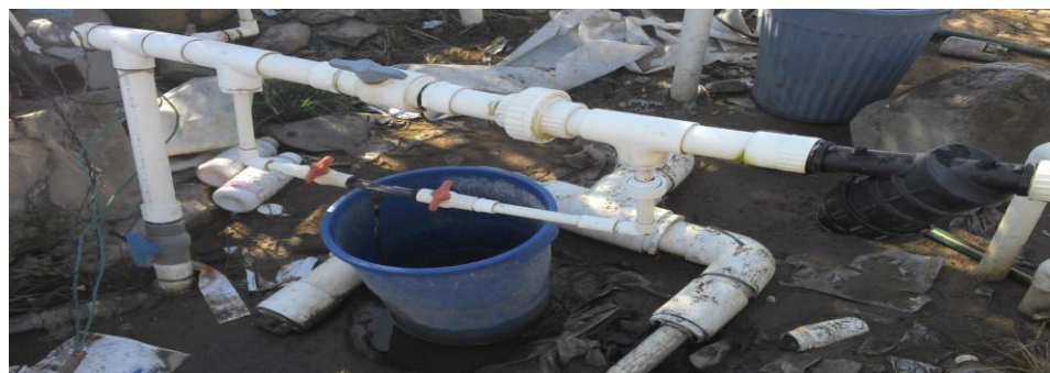
Figura 9. Sistema de fertirrigación utilizado para la inyección de los productos químicos al riego (venturi).
