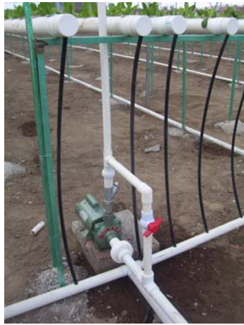
Figura 6. Bomba de propulsión. Invernaderos Top-Green.
