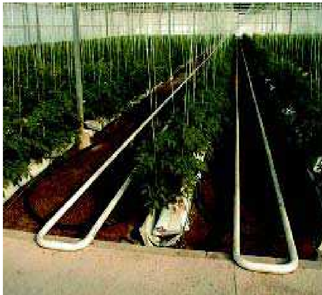
Figura 2.7: Sistema por agua caliente en tubería de hierro
