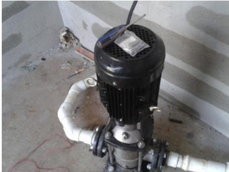
ILUSTRACIÓN 8 BOMBA CENTRÍFUGA VERTICAL (FUENTE, JIMÉNEZ, 2017).
