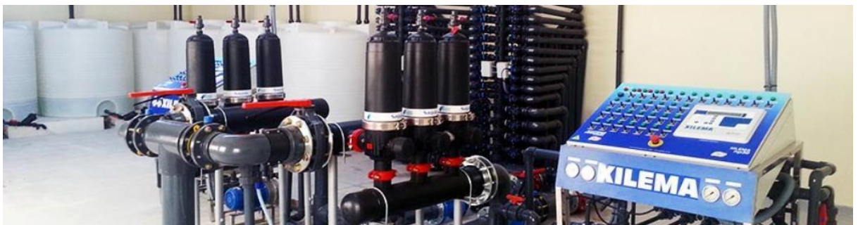
ILUSTRACIÓN 6 CABEZAL DE RIEGO DE LA MARCA KILEMA CON TODOS SUS ADITAMENTOS DE CONTROL (FUENTE NOVAGRIC).
