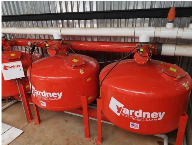
ILUSTRACIÓN 12 BATERÍA DE FILTROS DE GRAVA Y ARENA DE LA MARCA YARDNEY (FUENTE PROPIA)
