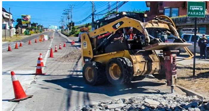
Fig.5 Contaminación por maquinaria de construcción
