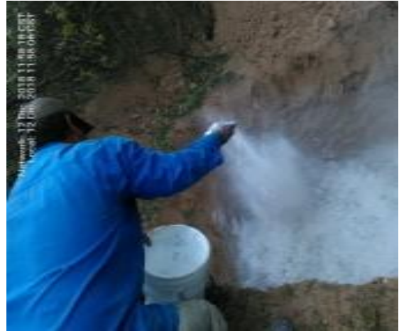
Fotografía: Nelvi Pérez Gálvez Poner Cal a la fosa séptica, antes de poner desechos de animales, en la Unidad de Producción Pecuaria del productor Luis Romo Gutiérrez. Ejido Nueva Fracción de, San Buenaventura, Coahuila.
